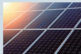
CASE.04 メガソーラー発電所
